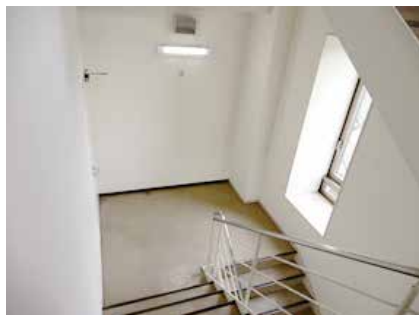
図表6-10. 誘導灯人感センサー・ 段階調光LED照明
