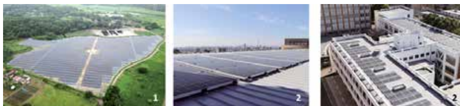
図表6-1. 千葉商科大学所有の太陽光パネル
