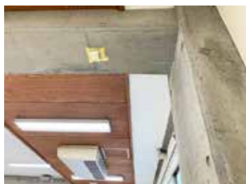
天井近傍に設置
