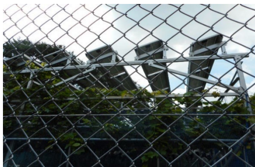
畑の上部に設置した太陽光パネル
