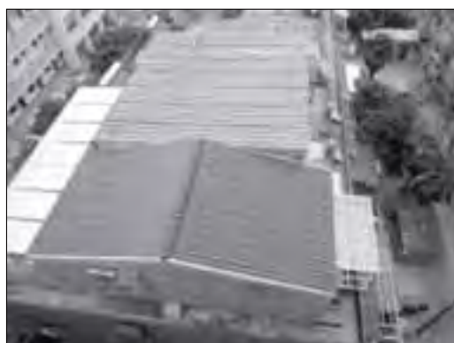
【写真 11】ビルの屋上の違法建築
